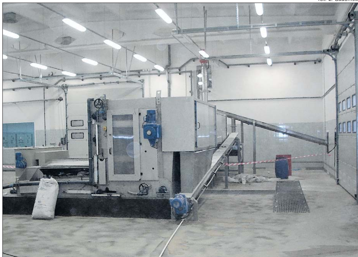
Prasa odpadów w nowym budynku przeróbki osadów
