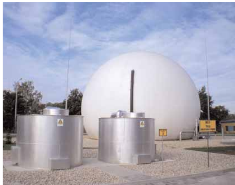
Strefa odzyskiwania i gromadzenia biogazu
