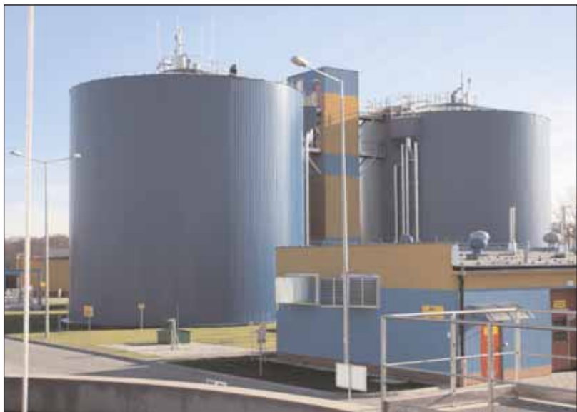
Biogaz, który powstaje w wydzielonych komorach fermentacyjnych jest wykorzystywany do produkcji energii elektrycznej zużywanej w oczyszczalni
