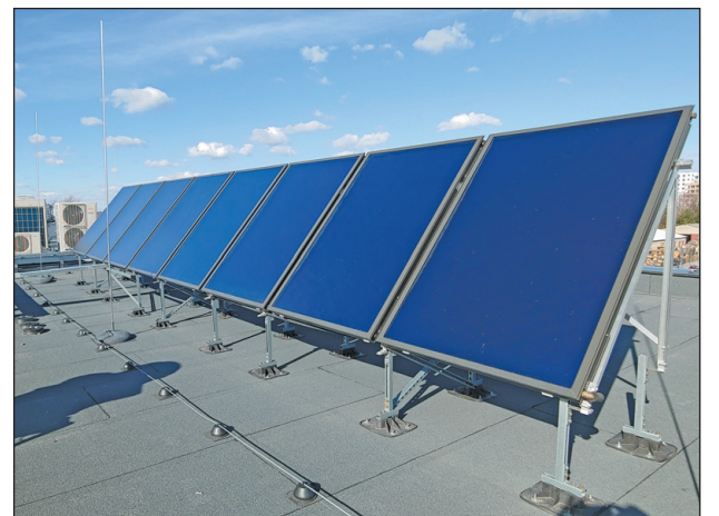
Panele słoneczne na dachu budynku CEM w Piasecznie
