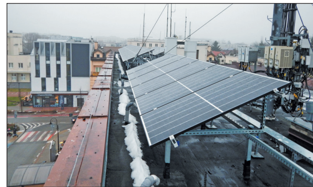
Panele fotowoltaiczne na dachu UMiG Piaseczno
