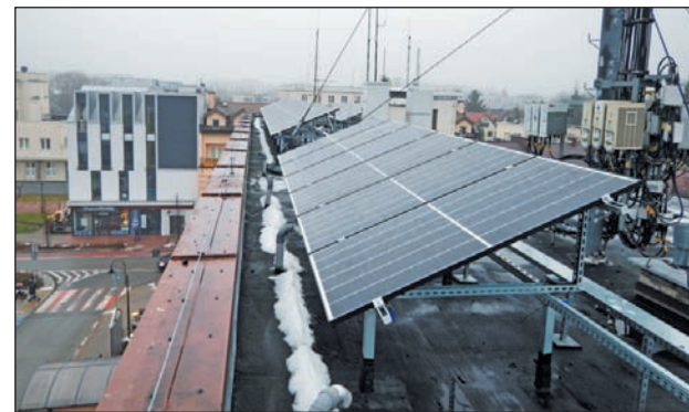
Panele fotowoltaiczne na dachu UMiG Piaseczno
